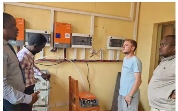
Menard und Tim vor einer Solaranlage
